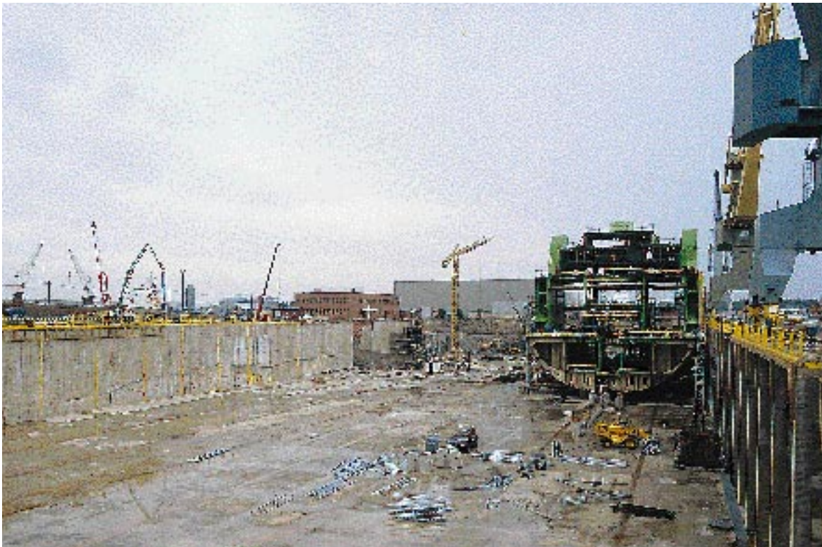
Finnyards Oy:n allastelakka on massiivinen rakennusprojekti, jonka A-vaihe valmistui touko-kesäkuun vaihteessa ja B-vaihe marraskuussa 1994. Betonia kului noin 25.000 m 3 eli 5.000 autokuormallista. Altaan pohjan pinta-ala on lähes 2,5 ha.
