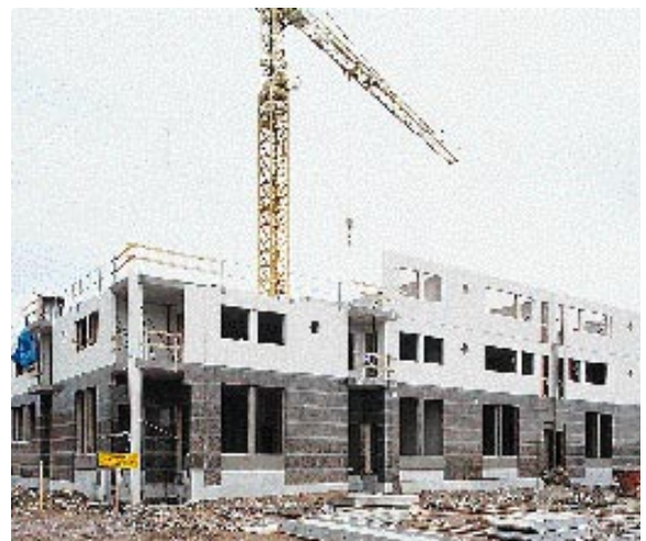
Merimieseläkekassalle Helsingin Ruoholahteen rakennettavan Asunto Oy Helsingin Seiloriin rakennustyöt käynnistyivät keväällä -94. Rakennuksen tilavuus on 15.500 m 3 ja siinä on 50 asuntoa.
