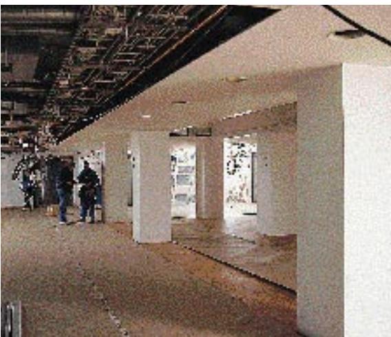
Kansikuassammekin esiintyvän Aleksanterinkatu 17 toimisto- ja liikerakennuksen saneerauksessa muutetaan mm. rakennuksen tilajärjestelyt ja uusitaan kiinteistön tekniset järjestelmät. Työn valmistuttua tiloissa aloittaa toimintansa World Trade Center – Helsinki.
