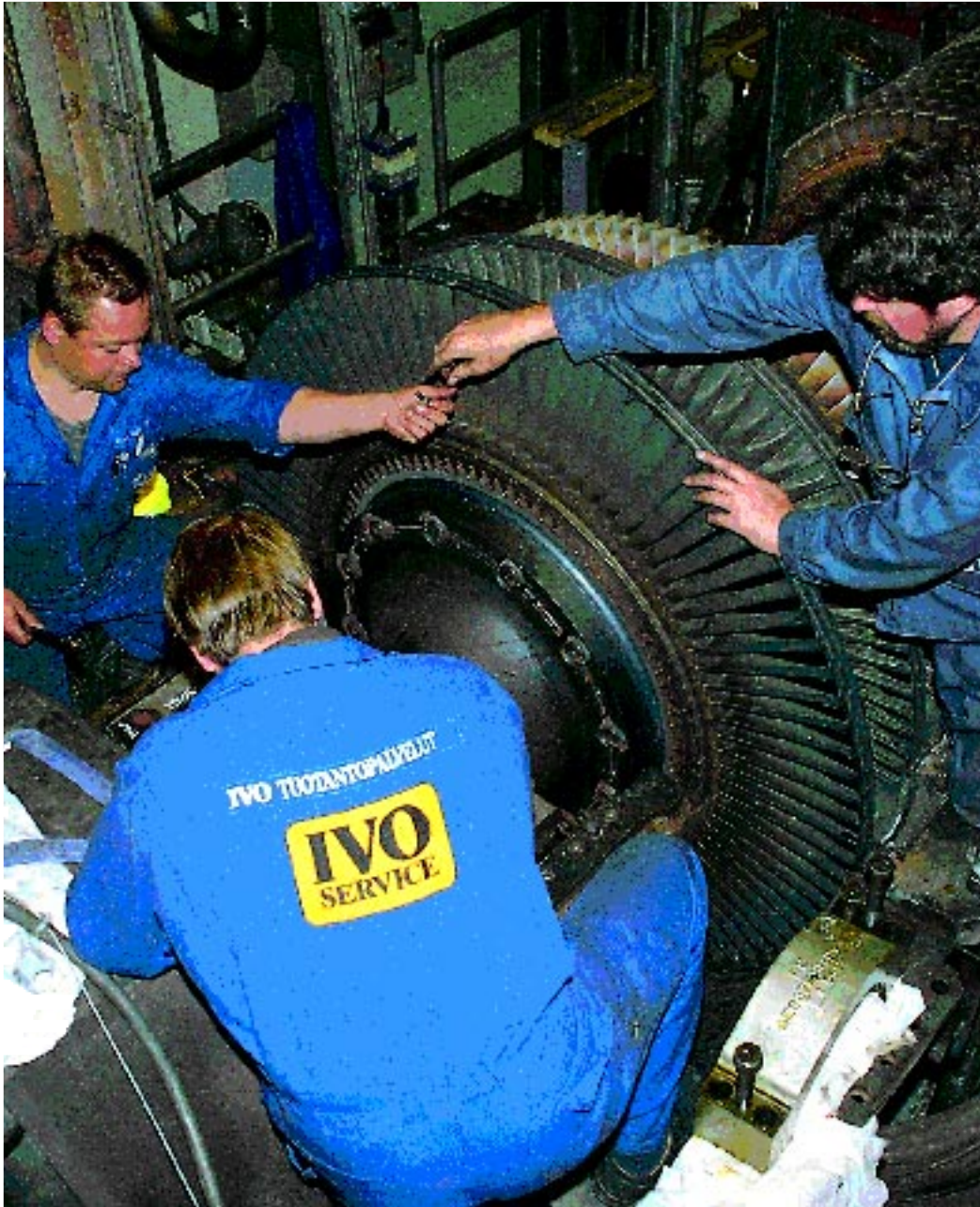
Vanajan voimalaitoksella IVO Service huolehti kaasuturbiinin vuosihuollosta.
