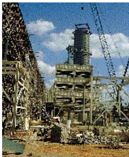
Malakan kaasuvoimalaitoksen neljäs ja viimeinen yksikkö valmistuu vuoden 1995 alkupuolella.
