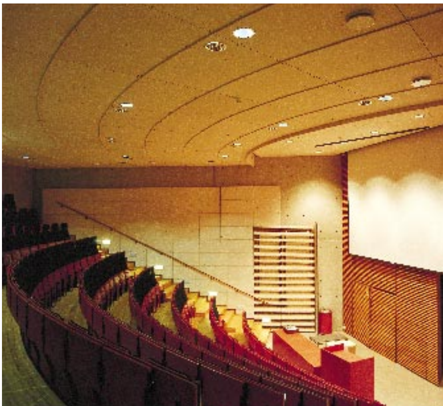
Punkaharjulla Suomen metsämuseon ja metsätietokeskuksen Luston auditoriossa on Helvarin toimittama valonohjausjärjestelmä ja valaisimissa Helvarin elektroniset liitäntälaitteet.
