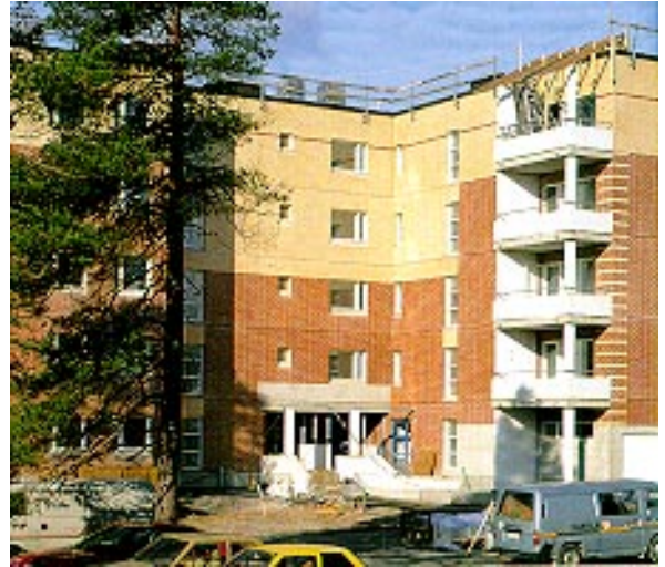
Vaparaahoitteista omaa asuntotuotantoa edustavan Asunto Oy Espoon Ruutikellarintie 11:n rakentaminen jatkui tilivuoden lopussa Espoon Leppävaarassa. Rakennuksen tilavuus on 8.500 m 3 ja siinä on 24 asuntoa.
