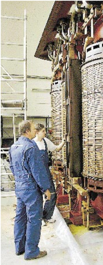
Tehomuuntajien kunnossapidosta IVO Servicellä on pitkäaikaista kokemusta ja vahvaa ammattitaitoa.
