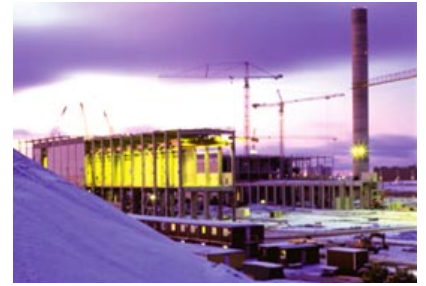
Partek Betonila toimitti Metsä-Rauman uuteen selluloosatehtaaseen vuosina 1994 ja 1995 massalinjan, kuivaamon, paalivaraston ja kuorimon rungot sekä osan seinäelementeistä. Kohteessa käytettiin ensimmäistä kertaa kuorilaattoja kone-tasojen valamiseen, mikä nopeutti työtä ja lyhensi rakennusaikaa.
