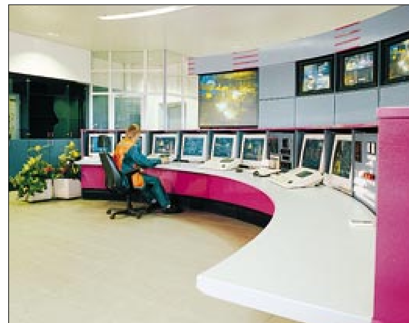
Raahen terästehtaan masuuni nro 1 uudistettiin kesällä ja masuuni nro 2 uudistetaan keväällä 1996. Kuva uudesta ohjaamosta.
