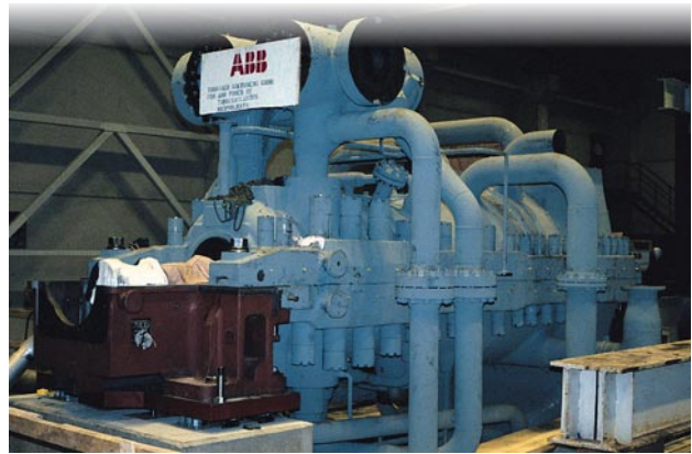
Oy Metsä-Rauma Ab:n uudelle sellutehtalle toimitettiin turbiinilaitos.
