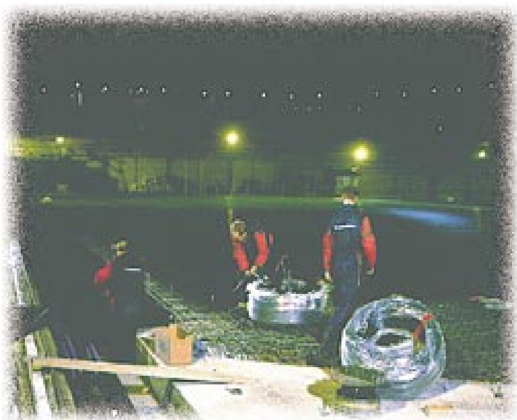
Kevään 1997 jääkiekon MM-kisojen suorituspaikalle, Hartwall Areenalle Helsingissä, Uponor on toimittanut noin 25 km kaukalon jäädyttämiseen tarkoitettua PELM-putkea.
