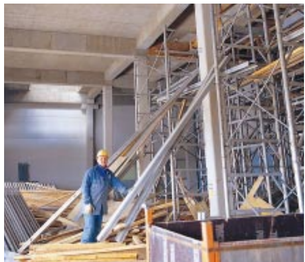
Kemira Pigments Oy:lle Poriin tehtiin Spin Flash -kuivaamo. Laajennus edellytti rakenteiden vahvistamista ja perustusten uusimista toimivan tehtaan sisällä.
