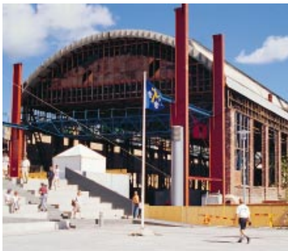
Vanhan köysitehtaan 300 metriä pitkä köysirata ja 30-luvulla rakennettu telakkahalli Aurajoen rannalla saneerataan Turun taiteen ja viestinnän oppilaitoksen käyttöön opetus- ja näyttelytiloiksi. Vanhasta telakkahallista jäävät jäljelle vain tiili- ja teräsrunkopilarit. Uusi runko rakennetaan näiden sisäpuolelle. Varasto- ja sosiaalirakennuksesta saneerataan tilat Turun Piirustuskoulun käyttöön. Köysiradan ja sosiaalirakennuksen väliin tulee 5.500 m 3 uudisrakennus. Kohteen koko tilavuus on 41.000 m 3 .
