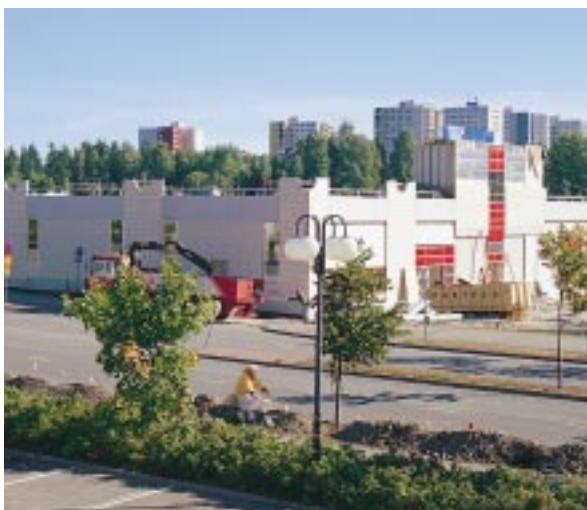
Sentra Oy:lle rakennettiin KVR-urakkana Eurospar-mymmä Vantaan Koivukylään. Kauppapaikka avattiin lokakuussa 1996. Rakennuksen bruttoala on 2.900 m 2 ja tilavuus on 18.000 m 3 .
