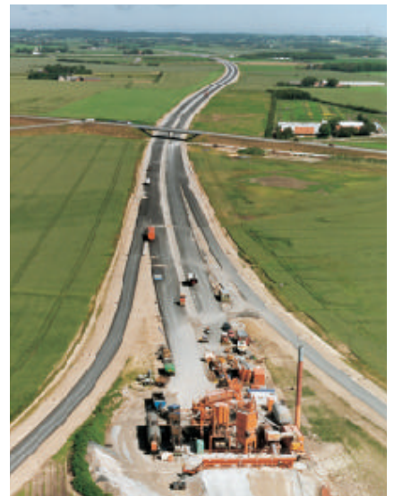
Tanskassa Lemminkäisen asfalttiliiketoiminnan markkinaosuus oli 11 % . Yhtiön asfalttiasema Hjørringissä, Pohjois-Jyllannissa.
