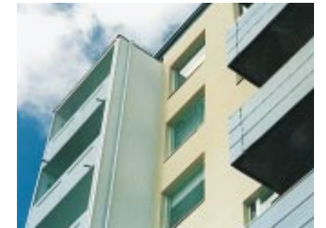
Yli puolet vuoden 1996 rakentamisesta Suomessa koostui korjausrakentamisesta. Gammelbackan asuinalueen peruskorjauksessa Porvoossa käytettiin Entra 2000 -korjausmenetelmiä. Työn alla oli viisi taloa ja lähes 200 huoneistoa.
