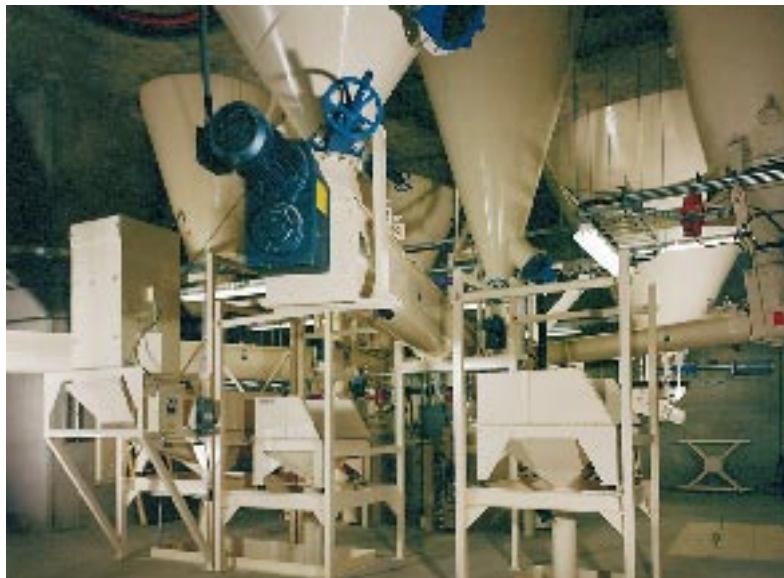
Pienaineiden vastaanotto- ja annostuslaitteistoa Guardianin menkilaitoksessa.
