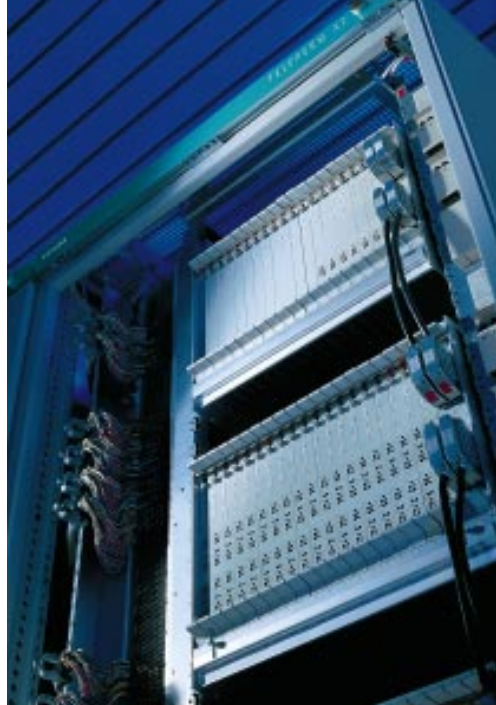
Uusinta voimalaitosautomaatiotekniikkaa edustaa Teleperm XP.
