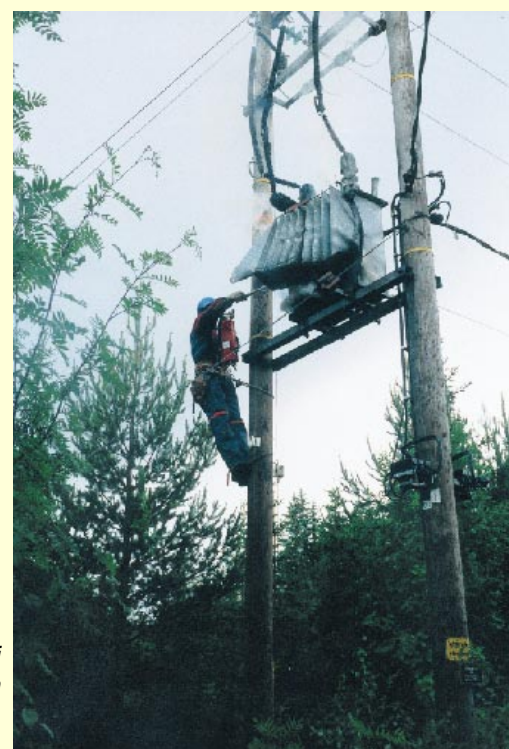
Ukkonen tuhosi Peräläntien muuntajan Palokassa kesäkuussa. Kuva Hannu Luoma.
