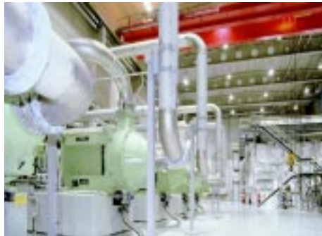
Enso Fine Papersin LUMI 7-paperikoneprojektissa Oulussa YIT:llä oli mittavat putkisto-, säiliö-, teräsrakenne- ja betonityöurakat
