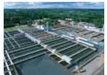
Suomenoja effluent treatment plant, Finland
