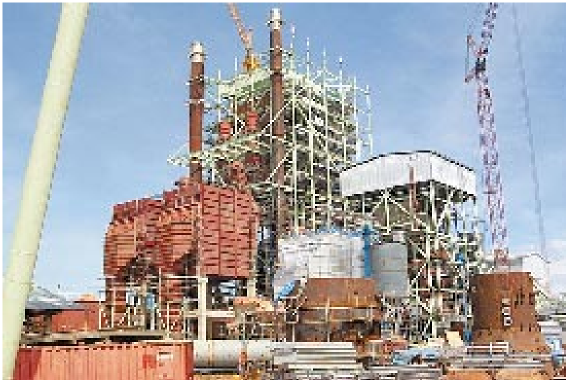
Kvaerner Pulping Oy toimittaa Indonesi- aan PT. Tanjungenim Lesta Pulp & Paperil- le soodakattilan 2120 tka/24h ja lei- jukerrosvoimakattilan 42 kg/s, 63 bar, 455 °C. PI on tehnyt molempiin kattiloihin teräsrakenne-, laitos-, painerunko-, laite- ja kanavistosuunnitte- lua.
