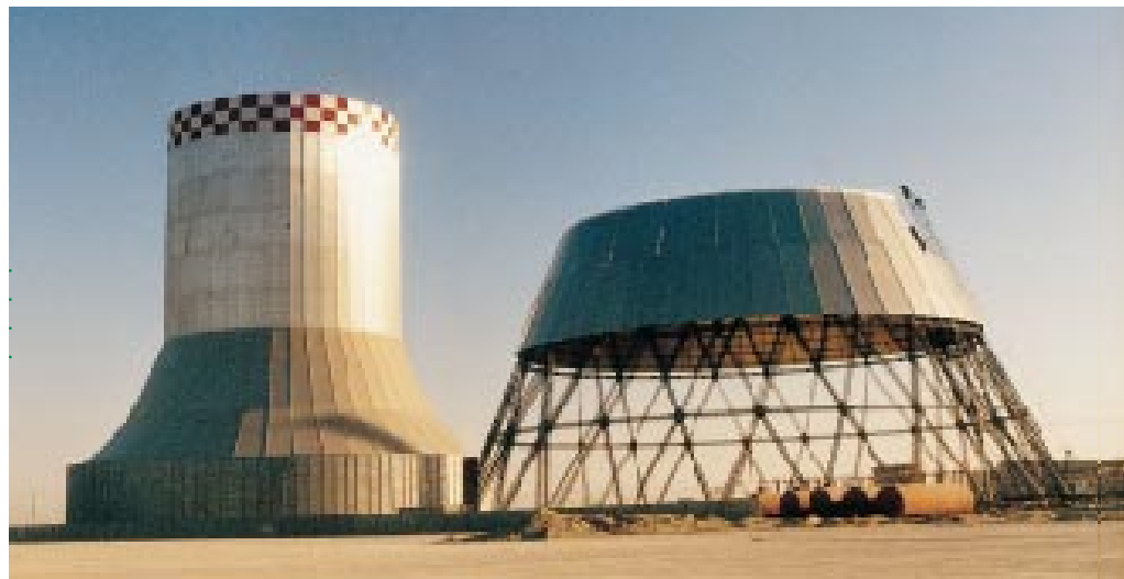
Vuonna 1998 yksi PI-HUNin tärkeimpiä suunnittelukohteita oli teräksisten jäähdytystornien suunnittelu Al-Zaran voimalaitokselle Syyriaan. Tornit on rakennettu teräksestä ja päällystetty alumiinisilla aaltolevyillä. Tornien korkeus on 135 m ja yläosan halkaisija 62 m. Tehtävän vaativuutta lisää se, että valtava rakennelma on altis tuulelle ja se sijaitsee maanjäristysherkillä alueella.
