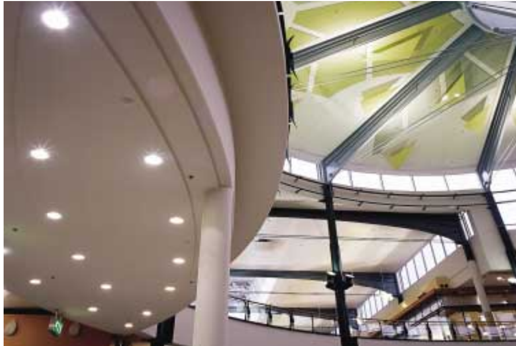
Tekmanni toimitti sprinklerijärjestelmän Kauppakeskus Myllyyn Raisiossa. Yhtiö toteutti myös rakennuksen sähköurakan.
