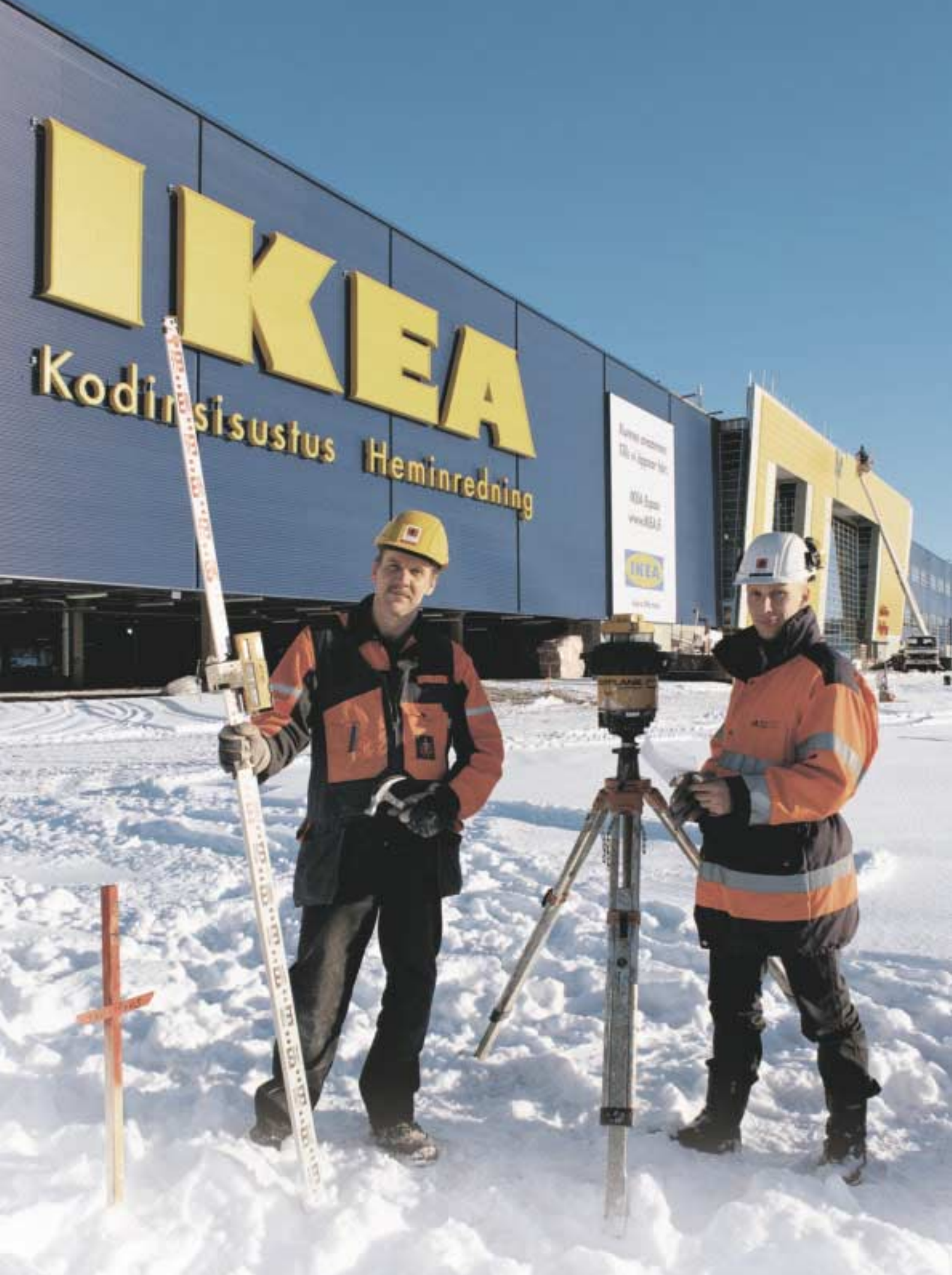
Carpenter Keijo Keski-Korhonen and head foreman Jyrki Perokorpi on the site of IKEA's new store in Vantaa.
