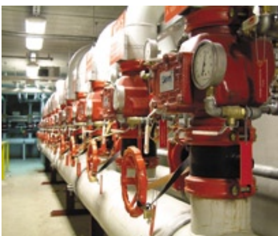
Hartwallin Lahden tehtaiden sprinklerilaitteistoa.
