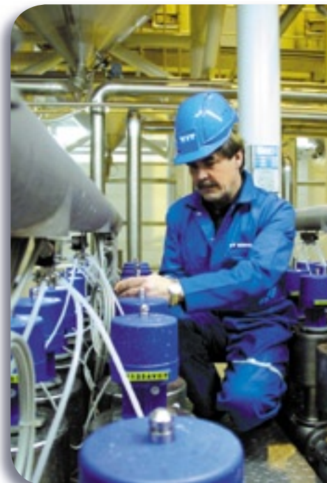
Jorma Heinonen tarkistamassa pumppujen automatiikan kuntoa Koffin Keravan tehtailla.
