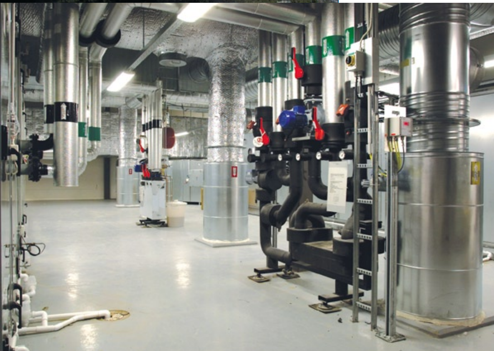
Swedish Match, uusi nuuskatehdas, Kungälv: Putkistoasennukset, mm. lämpö, kaasu, erilaiset jäähdytysjärjestelmät, lämmön talteenotto, paineilmajärjestelmät sekä erilaiset käyttövesi- ja viemärijärjestelmät.
