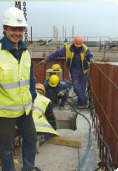
Pietarin lounaisen jätevedenpuhdistamon rakentaminen jatkui vuonna 2003 YIT:n, NCC:n ja Skanskan perustaman SWTP Construction Oy:n toimesta. Hanke on tärkein Suomenlahden ja Itämeren tilaa parantava ympäristönsuojeluhanke.
