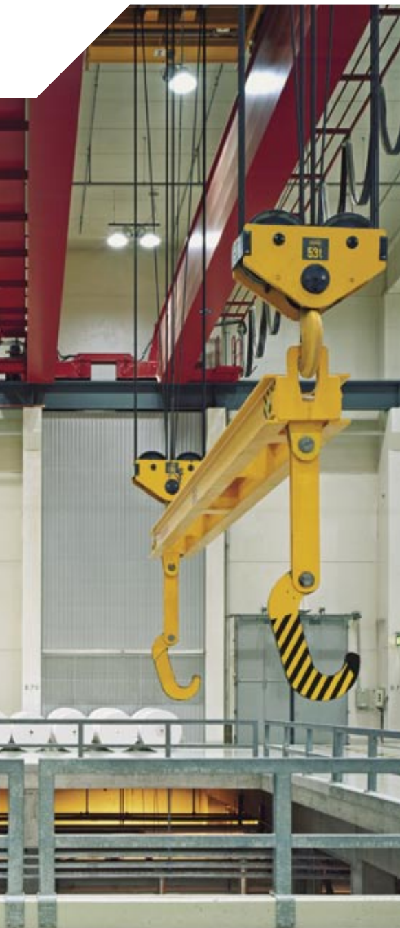
Vasen kuva: Konecranesin prosessintuuri M-Realin Kirkiemen paperitehtaalla Oikea kuva: Konecranesin kumipyöräkonttintuureita, APM Terminals, Los Angeles, USA
