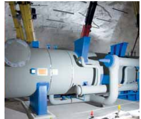
Kakolan jätevedenpuhdistamon yhteyteen rakennettu lämpöpumppulaitos tuottaa 18 MW kaukolämpöä ja 35 MW kaukolämpöä. Käsitellystä jätevedestä talteenotettava hiilidioksidivapaa lämpöenergia vastaa noin 4 000 pientalon vuotuista lämmöntarvetta. Laitoksessa on varaus toiselle samantehoiselle lämpöpumpulle.
