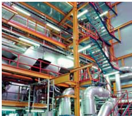
Orikedon biolämpökeskus tuotti vuonna 2008 yli 16 % Turun kaukolämmöstä uusiutuvalla puuhakeella. Lämpökeskuksessa on paikka tehon kaksinkertaistavalle toiselle kattilalle.
